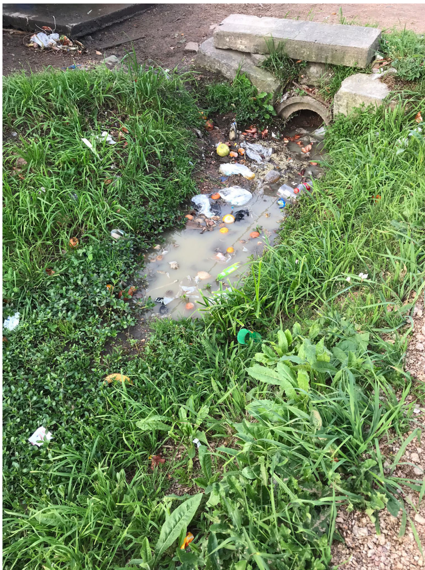
Figura 6 - Foto Cuneta contaminada en los márgenes de la ruta 8 en km 16. Esta cuneta desemboca luego de un kilómetro aproximadamente en el cauce del arroyo Manga. Autoría Lucía Abbadie
