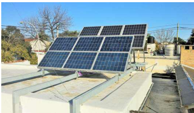
Fig. 2: Vista Aérea del arreglo de paneles
