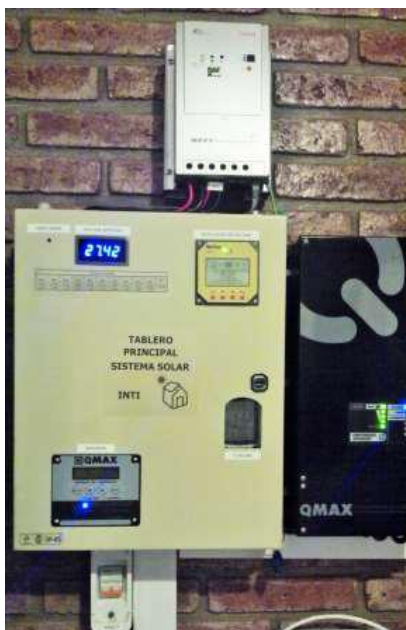
Fig. 3: Tableros de Control y Operación del Sistema Solar Fotovoltaico
