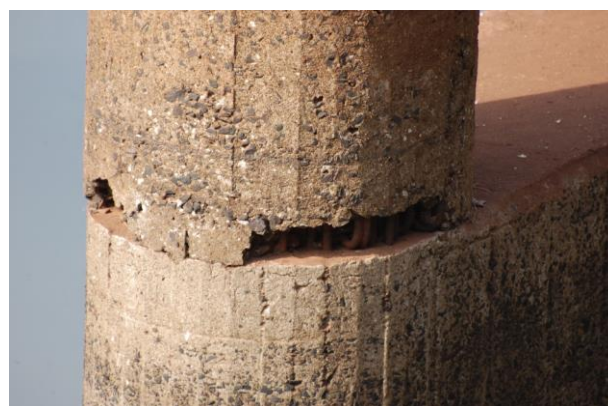
Fig. 3. Problemas de colado en vinculación entre columna y riostra de pila del Eje III.
