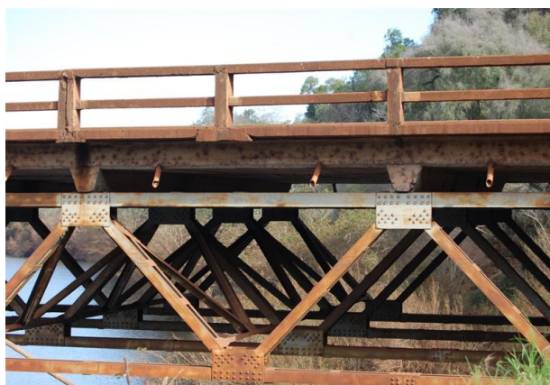
Fig. 2. Vista lateral de las vigas reticuladas, nervios transversales, losa y barandas laterales.
