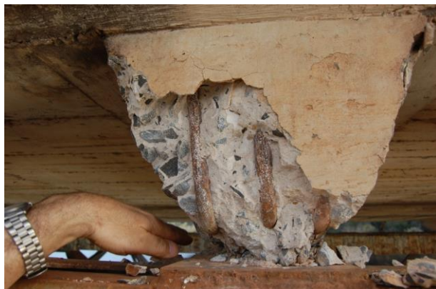
Fig. 4. Nervio deteriorado por martilleo sobre viga metálica
