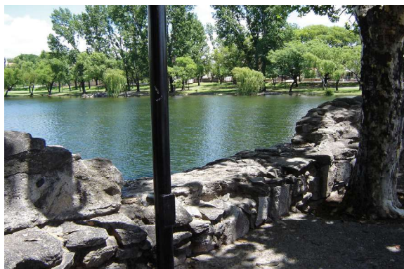
Figura 7: Zona del muro principal con el recercamiento destruido.
