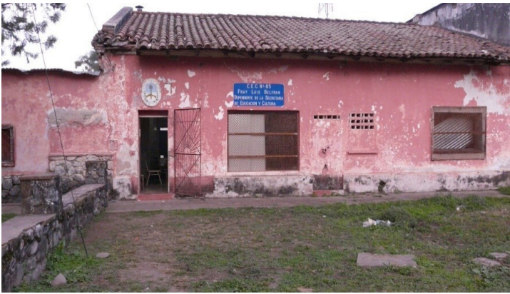
Figura 2. Frente de la Escuela Fray Luis Beltrán (TUC SL3). Fotografía tomada por la autora Año 2015.
