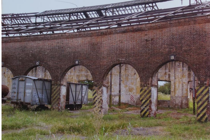
Figura 6. Estado del edificio previo a su recuperación.
