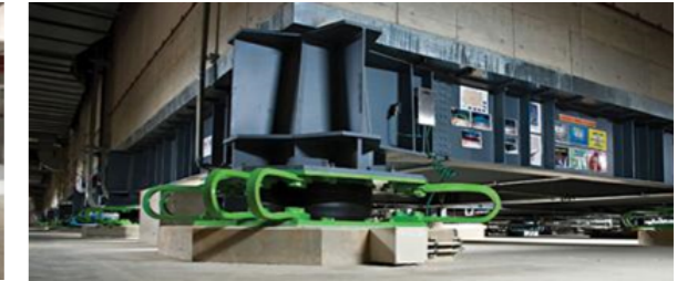
Hospital Ishinomaki de la Cruz Roja con un sistema aislamiento-disipación. La superestructura de hormigón armado se apoya en un chasis de vigas de acero sobre aisladores de neopreno. Las piezas verdes en forma de "U" son disipadores adicionales. www.structuremag.org
