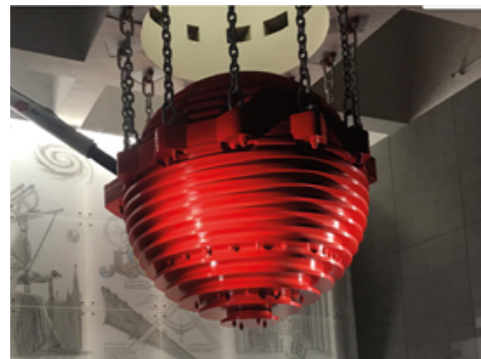
Amortiguador de masa sintonizada. Edificio Cámara Chilena de la Construcción ( www.revistabit.cl )
