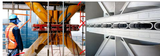
Edificio Titanium, Chile. Disipador de placas plegadas. www.adi-ag.cl
