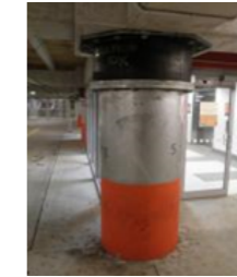
Aislador elastomérico en el capitel de una columna de acero en el subsuelo de un edificio. www.architecture.org.nz
