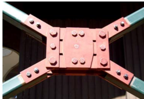
Disipador por fricción tipo Pall. Rehabilitación de un edificio de 14 pisos (Shao, Pall y Soli, 2012)
