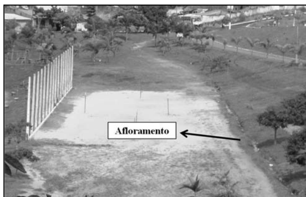
Figura 12. Afloramento de água na base de talude da Área 3.
