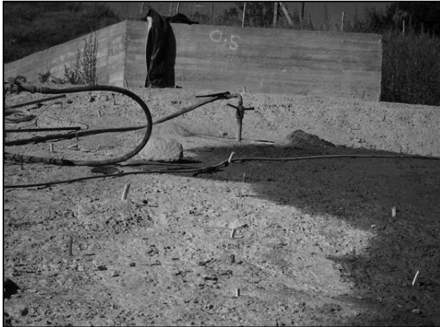
Figura 14. Bloque 1. Al fondo, obturador instalado en un taladro de inyección. En primer plano se observan los taladros de inyección de consolidación finalizados y demarcados para su individualización y control del desarrollo de la operación del tratamiento.
