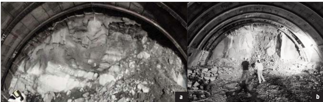
Figura 15. T3. a) Bloques rotados. b) falla paralela al eje longitudinal del túnel.
