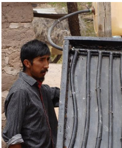
FIGURA 1. Bigote, junto al calefón solar construido e instalado por él
